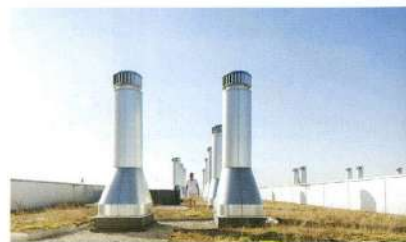
▲ Cheminées de ventilation naturelle © Atelier Gontier
